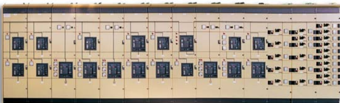
Rozdzielnica mocy typu OKKEN
